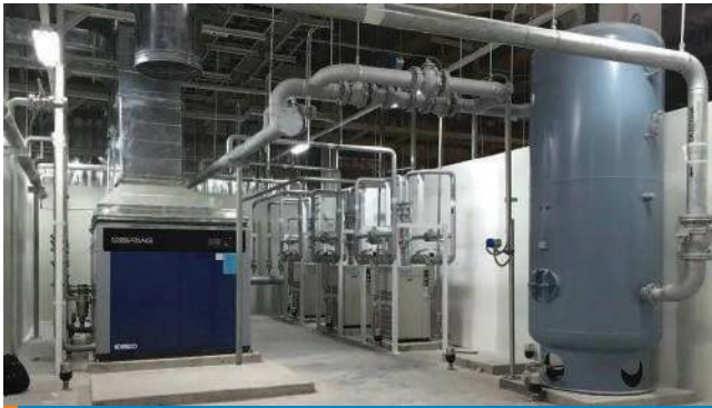
Hệ thống máy nén khí
